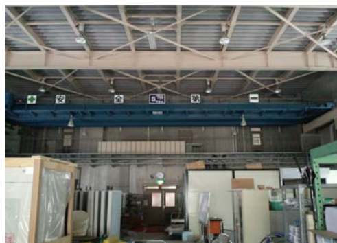
図1 天井クレーン（技術開発センター）
