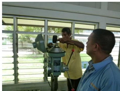
ボール盤主軸回転数変換用Vベルトの張り調節部の動きが悪いため、分解、調整、組立を行った
